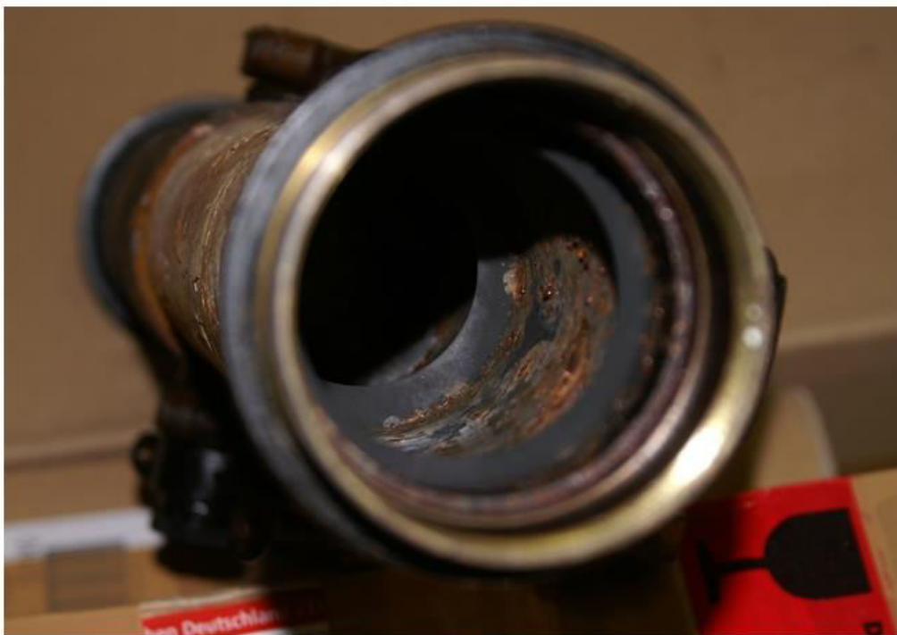
Rostablagerungen im Tubus-Inneren ! Zustand am 08.10.2014
